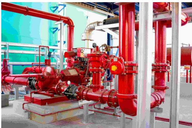
Figura 3: Bombas do Sistema Contra Incêndios
