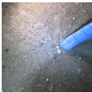
Foto 8 - Piso contaminado por mercúrio metálico em galpão industrial abandonado.
